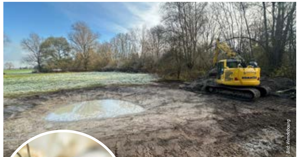
Mit dem Bagger hat der LPV die Teiche saniert und neue Tümpel ausheben lassen
